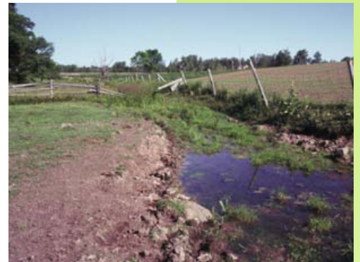
Le fait d'enlever la végétation pour faire place à des pâtures, à des cultures ou à des aménagements accélère l'érosion des berges et du lit des cours d'eau, donne des chenaux plus larges et moins profonds et peut conduire à l'inondation d'un vaste territoire.
