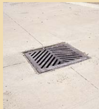
Un puisard est une fosse ou un réservoir servant à recueillir les liquides. Il est conçu pour la récupération et le transfert des déchets à court terme, PAS pour l'entreposage.
