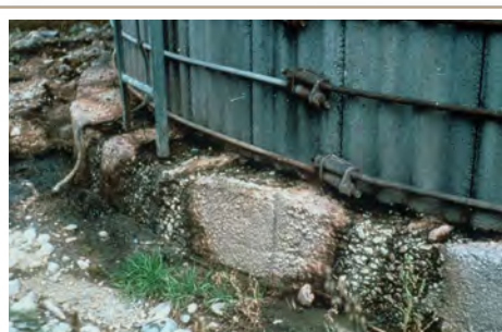
L'utilisation de matériaux appropriés et l'entretien du plancher du silo, des murs et des fondations peuvent minimiser l'écoulement des effluents. Il est également important que la structure des murs et des fondations soit solide pour la sécurité des travailleurs.
