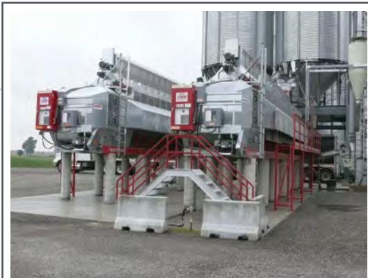
Les séchoirs à grains à haute température peuvent être modifiés pour en améliorer l'efficacité énergétique.
