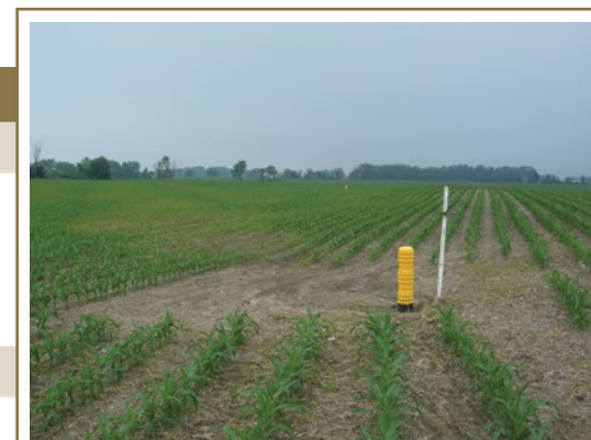
L'installation d'entrées de drain à la surface et l'aménagement d'un drainage souterrain amélioreront le drainage superficiel et réduiront le déplacement de l'eau à la surface du sol, diminuant ainsi le risque d'érosion du sol.
