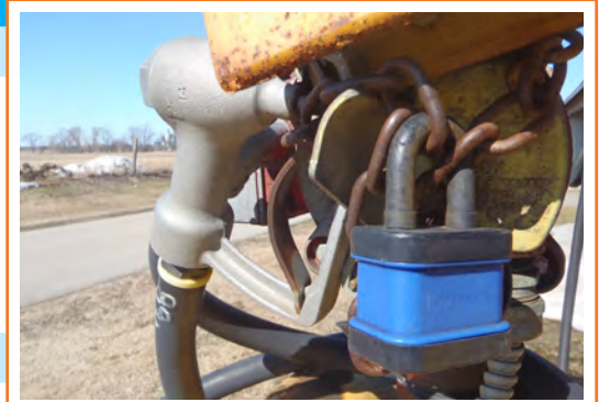
Cadenassé, le réservoir de stockage de combustible sera sécurisé contre tout accès non autorisé.
