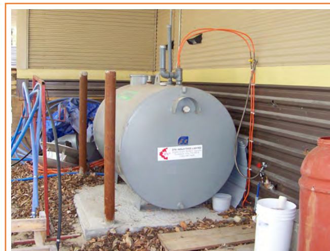
Il y a souvent des fuites au niveau des conduites.
