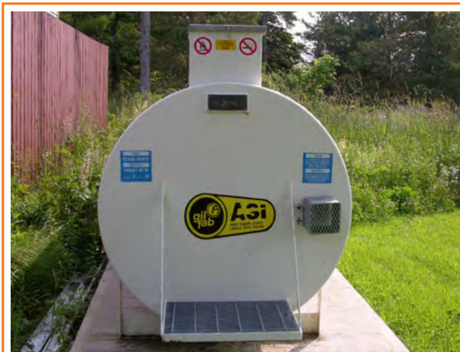
Évaluez l'état des réservoirs de stockage de combustible existants, et maintenez une protection contre la corrosion.
