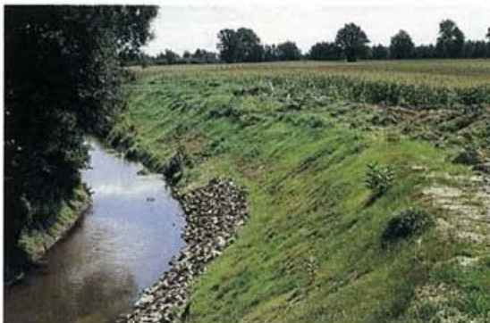
Minimisez le bouleversement en nettoyant un seul côté du drain à la fois. Dans le drain illustré, l'enrochement a été ajouté au méandre extérieur afin de réduire l'érosion.
