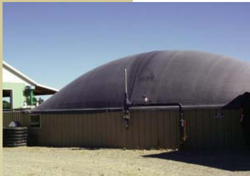
Le biogaz issu de la digestion anaérobie peut servir à la production de chaleur ou d'électricité.
