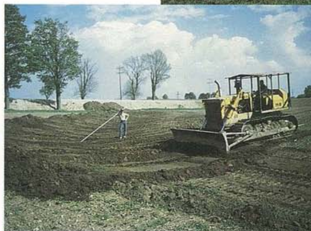
En Ontario, on se sert généralement de bulldozers pour aménager les voies d'eau engazonnées. Un aménagement bien conçu peut s'avérer un investissement rentable.
