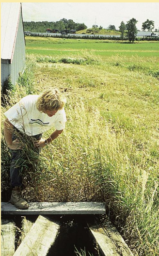
Voici un puits non utilisé en piteux état. Il menacera la qualité de l'eau souterraine et la sécurité des êtres humains, du bétail et de la faune jusqu'à ce qu'il soit colmaté.
